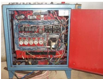
34. ábra - Villamos kapcsolószekrény vörös belső felülettel
